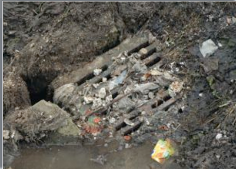
Рис. 8. Зруйнований повінню вуличний колектор. Дрогобицький р-н., Львівська обл.
