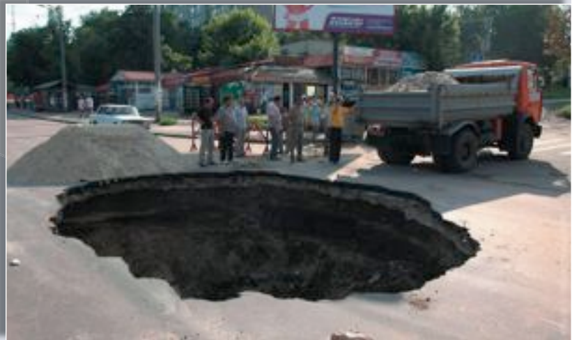
Рис. 24. Провал ґрунту на вул. Олени Теліги, Київ
